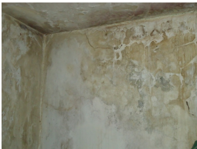
Figura 3: Humidade em excesso visível na parede.
