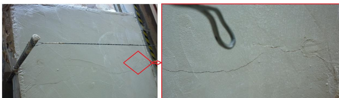
Figura 5.11 Fissura observadas nas primeiras 24 horas de cura da laje L2.
