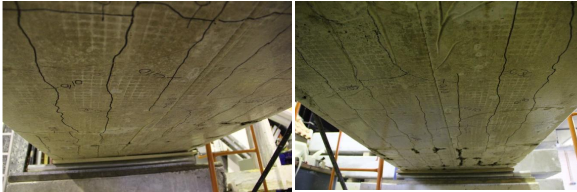
Figura 5.20 Levantamento de fissuras na parte inferior da laje L3 após a descofragem.
