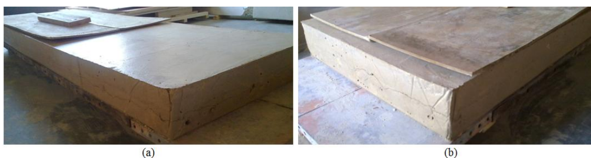
Figura 5.13 Laje L2 após 7 dias de cura, continuidade das fissuras nos lados adjacentes observadas: a) – do canto sudeste; b) – do canto sudoeste.
