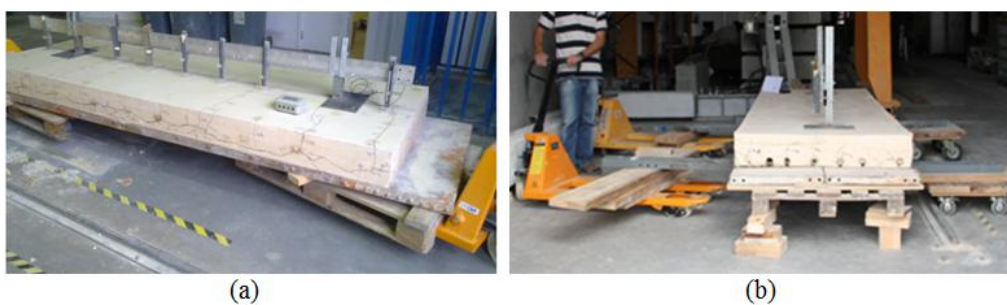
Figura 6.1 Sistemas de transporte das lajes até a zona de cobertura da grua: (a) - laje L2 ; (b) - laje L3 .
