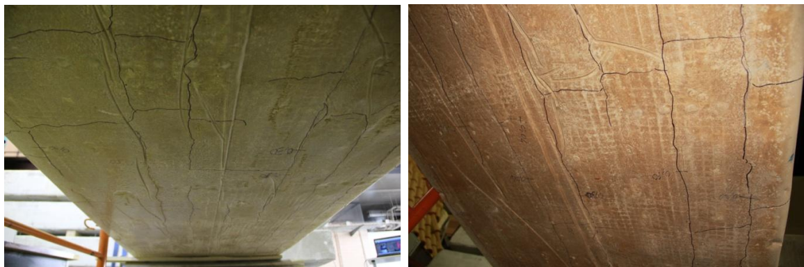
Figura 5.15 Levantamento das fissuras na superfície inferior da laje L2.
