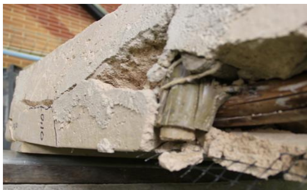
Figura 6.13 Laje L3: rotura da ligação.
