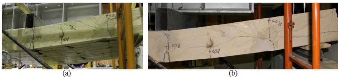
Figura 6.11 Laje L3 : a) – consolidação da fissura vertical na secção 2, b) – alastramento de fissura longitudinal para o interior do vão.
