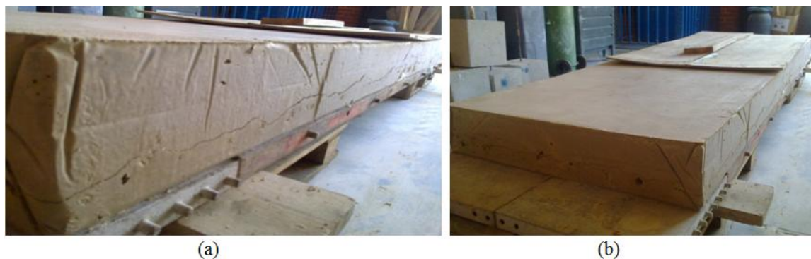
Figura 5.12 Laje L2 após 7 dias de cura: a) – fissuras longitudinais no lado norte; b) – continuidade das fissuras nos lados adjacentes observadas do canto nordeste.
