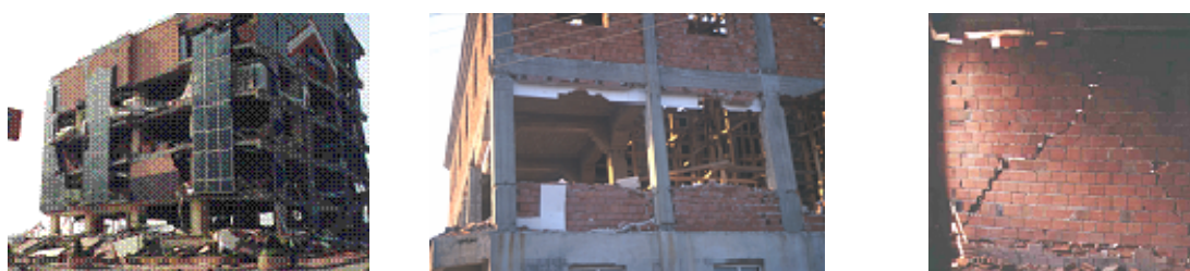
Figura 1 – Danos em edifícios associados à participação dos painéis de alvenaria [5]
