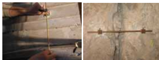
Fig 8 – Exemplo de aplicação dos sensores de fibra óptica
