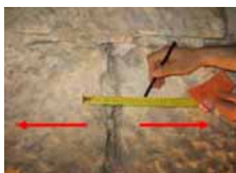
Fig 5 – Abertura de junta nas pedras do desvão
