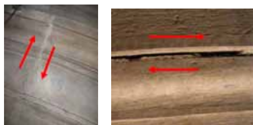
Fig 6 – Escorregamento entre pedras do arco
