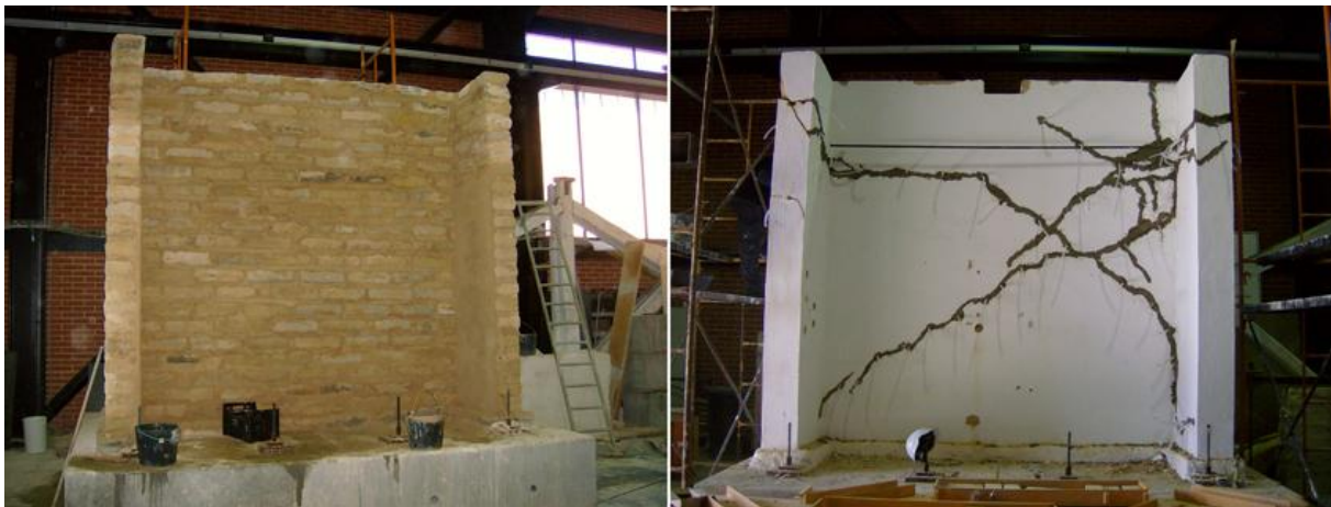
Figura 1: Parede de Adobe. Estrutura interna (esquerda). Aspecto após os testes mecânicos e reparação (direita).
