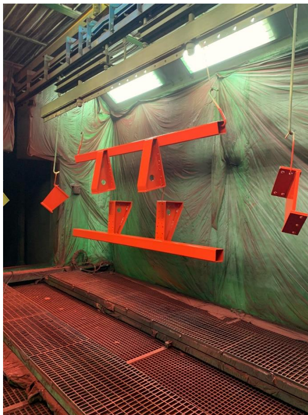
Figura 10 - Interior da cabine de pintura de esmalte
