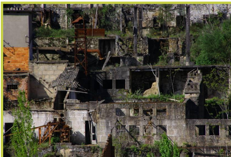
FIGURA 4: Imagem da lavaria “nova”. De destacar o estado de degradação em que se encontra esta estrutura mineira.
