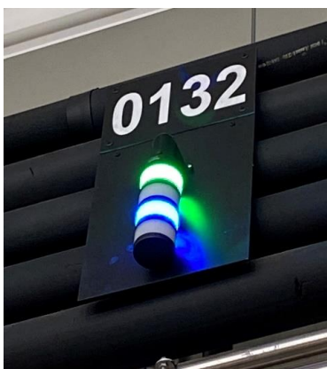
Figura 13 - Sistema Andon da OLI - Sistemas Sanitários, S.A.
