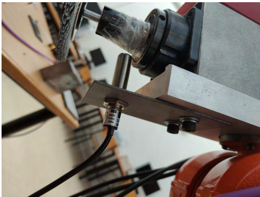
Figura 3.32: Instalação do sensor indutivo
