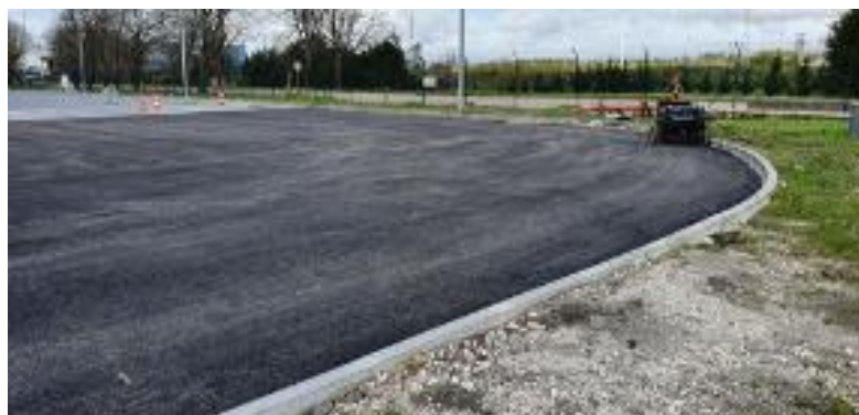
Figura 24. Troço da estrada pavimentada com e sem resíduos.
