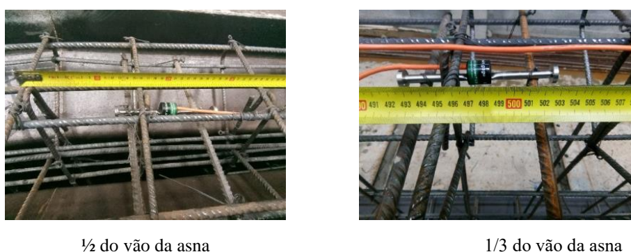
Figura 60. Instalação dos sensores internos ( \frac{1}{2} e \frac{1}{3} vão).
