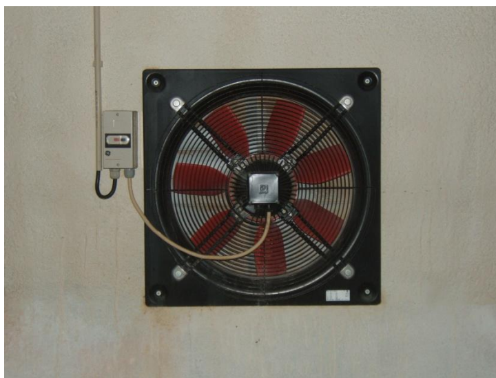
FIGURA 9 – VENTILADOR UTILIZADO NOS AVIÁRIOS
