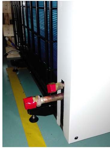
(b) Fan module - refrigerant flares.
