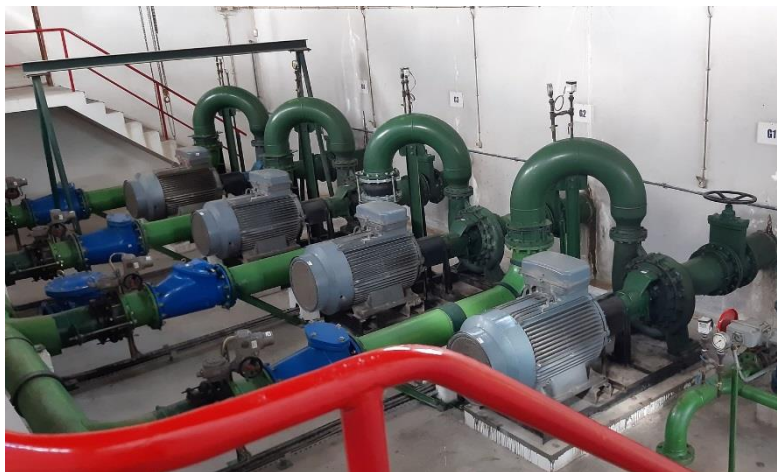
Figura 7: Estação Elevatória 1 (EE1)
