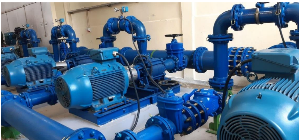
Figura 8: Estação Elevatória do Beco (EE BECO)
