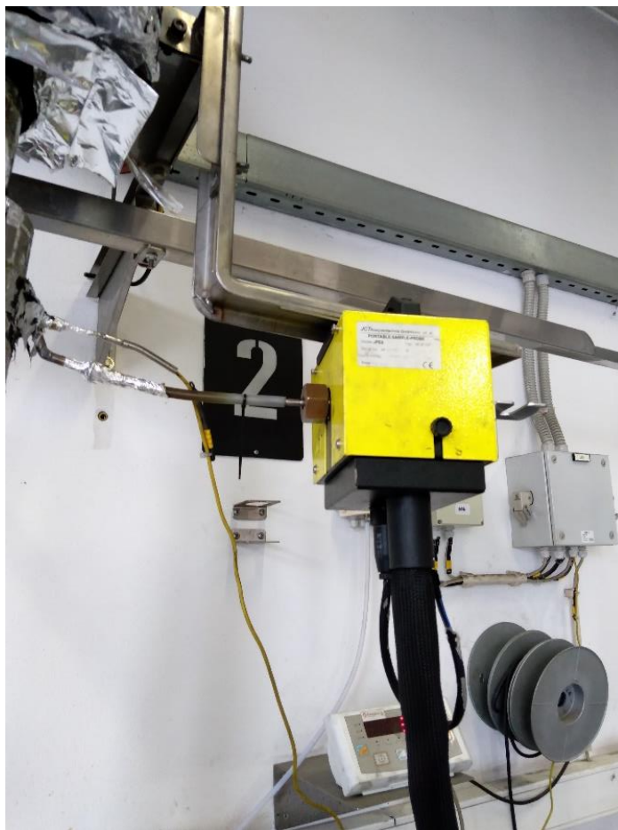
Figura 116 - Sonda de sucção, termopar e linha de transporte de amostras de gases de combustão da JCT Analysentechnik GmbH.
