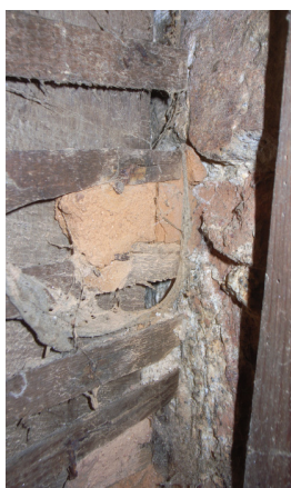
Fig. 1.92 Parede onde se removeu o emboço
