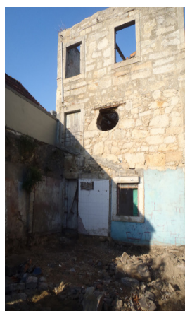
Fig. 1.44 Estrutura da casa após derrocada
