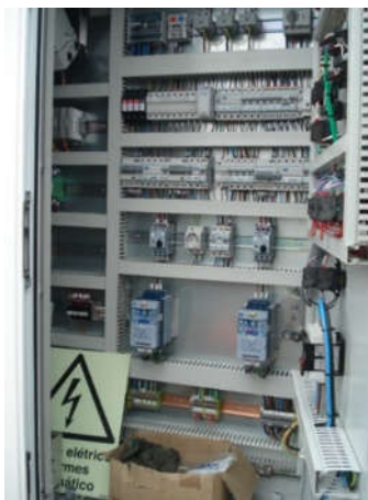
Figura 65 - Quadro elétrico de estação elevatória
