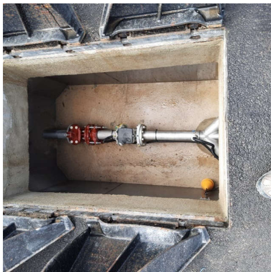
Figura 63 - Medidor de caudal instalado na câmara de manobras
