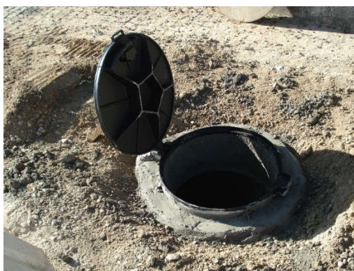
Figura 32 - Tampa D400 chumbada à câmara de visita
