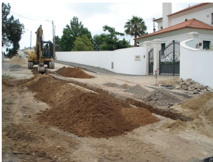
Figura 21 - Abertura de vala com deposição dos materiais escavados no bordo da vala
