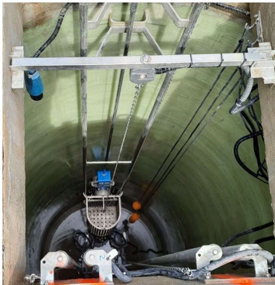
Figura 62 - Pormenor dos equipamentos instalados no poço de bombagem
