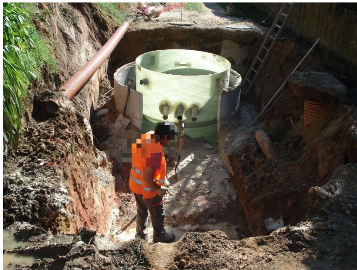
Figura 56 - Poço parcialmente aterrado
