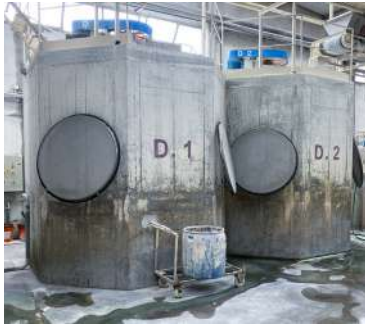
Figura 10 - Tanques de armazenamento da pasta líquida.
