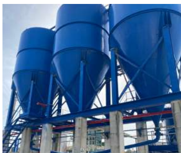
Figura 9 - Tratamento das águas.
