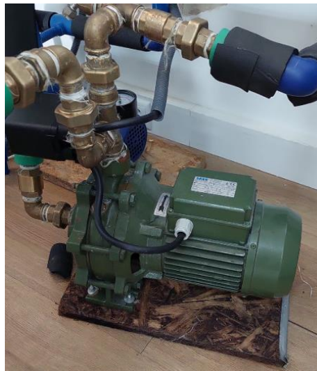
Figura 32 - Bomba de pressurização – SAER
