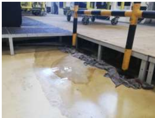
Figura 4.5- Fotografia ilustrativa da falta de estanquidade da plataforma.
