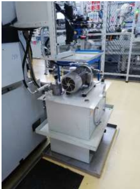
Figura 4.10- Fotografia ilustrativa de um Grupo de Refrigeração com uma retenção extra.
