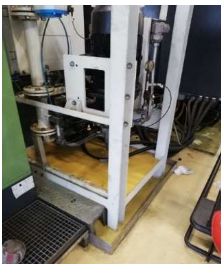
Figura E.3- Fotografia ilustrativa de um tabuleiro de retenção com óleo.
