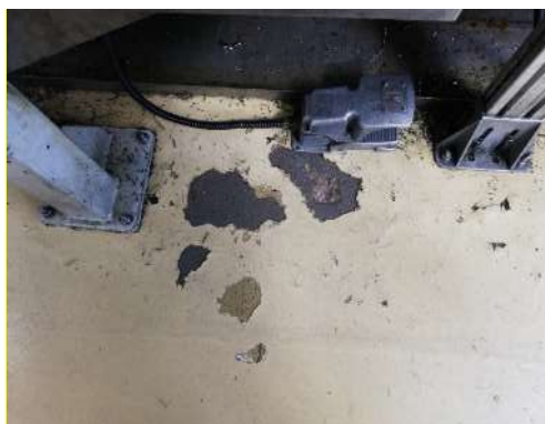
Figura E.1- Fotografia ilustrativa de um piso danificado devido à queda de peças.
