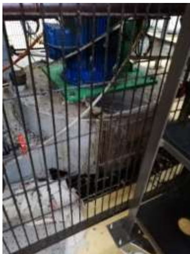
Figura 4.12- Fotografia ilustrativa de um reservatório de óleo com retenção abaixo do piso.
