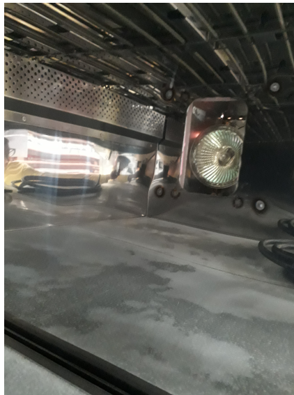
Figura 2.10: Iluminação atual numa cavidade na lateral de uma câmara do forno Modulram .
