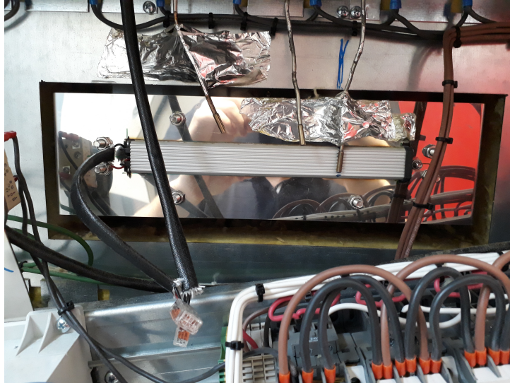
Figura 9.2: Sistema de iluminação com luminária LED sem isolamento aplicado nas laterais.
