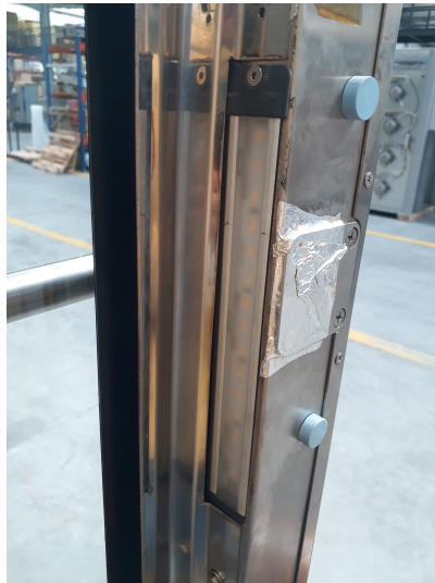
Figura 4.2: Aplicação da luminária LED BJB 77.116.1002.36 no lado do fecho da porta.
