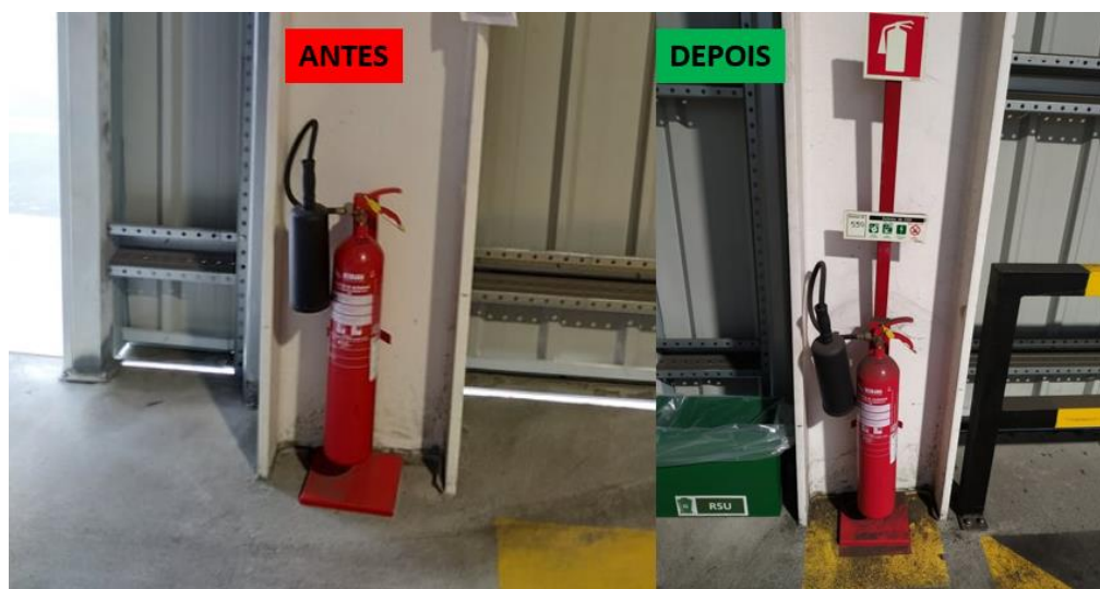
Figura 23 - Sinalização dos extintores
