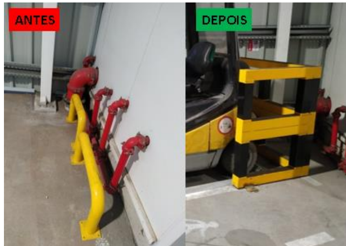
Figura 25 - Grades de proteção dos tubos de água
