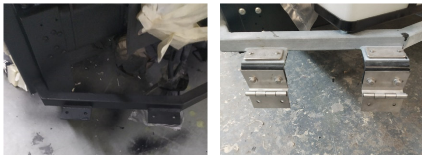
Figura 27 - Falta de Componentes.
