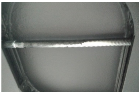
Figura 17 - Falha de Tinta.
