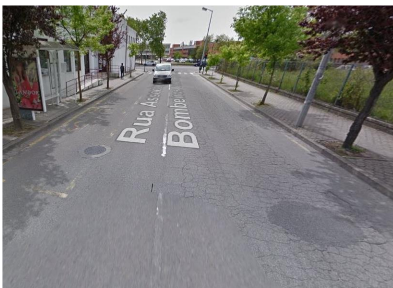
Figura 16 - Exemplo das degradações existentes na Rua Associação Humanitária dos Bombeiros Voluntários
