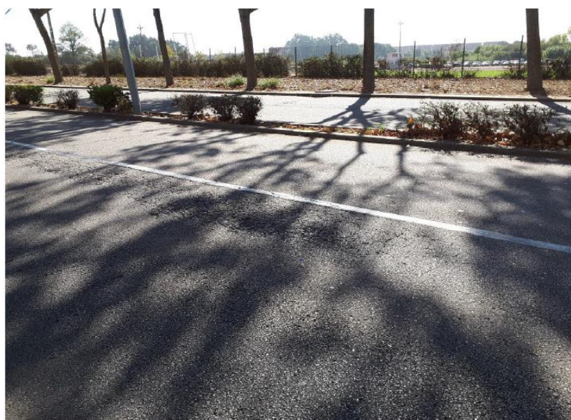
Figura 17 - Exemplo da degradação da Avenida de Universidade
