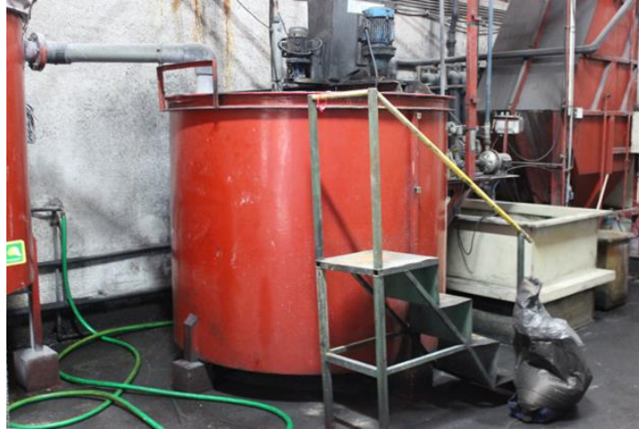
Figura 4.5: Segundo reator onde são adicionados o carvão ativado e o sulfato de alumínio e onde se faz a regularização do pH.
