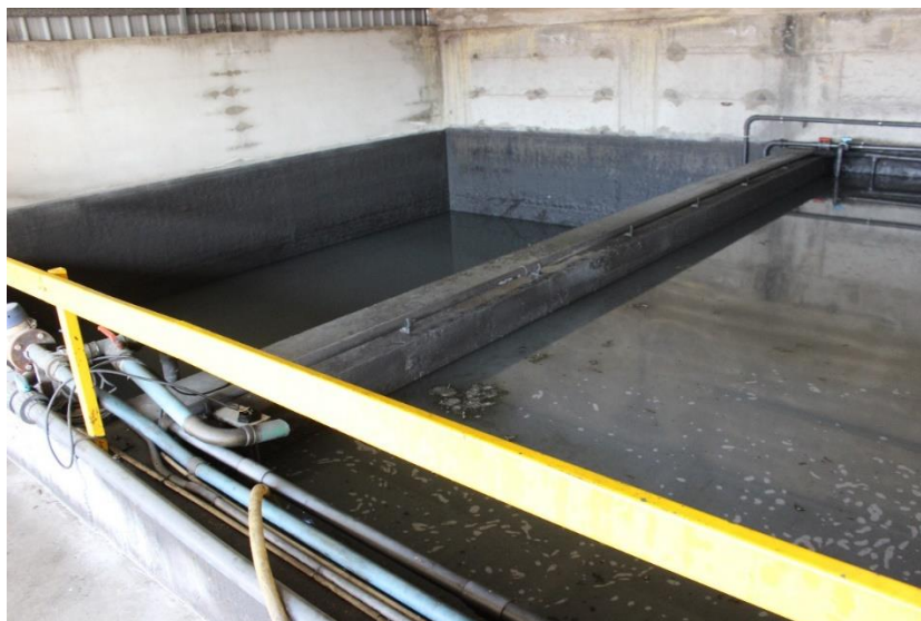
Figura 4.3: Tanque onde se processa a mistura das águas residuais de cada uma das linhas de produção.
