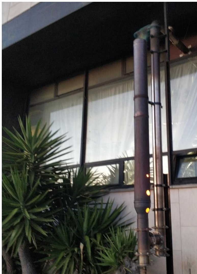
Figura 5.34- Queimador durante a gasificação de CDR.
