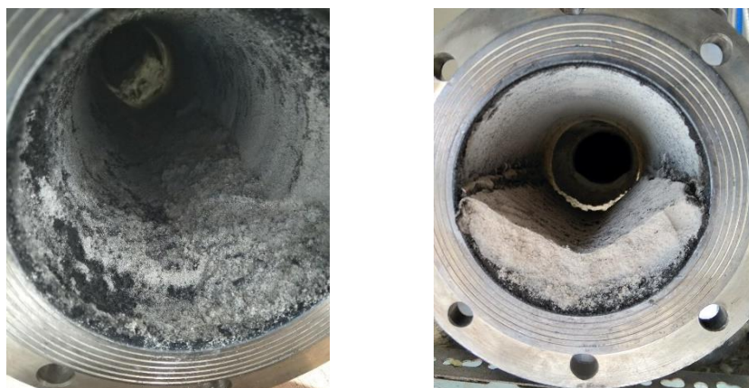
Figura 5.27- Acumulação de cinzas na conduta da exaustão após experiência de gasificação e co-gasificação até: a) 20% CDR e b) 100% m/m de CDR.
