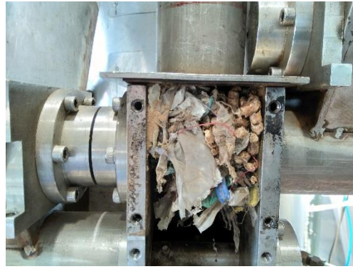
Figura 4.18- Obstrução na alimentação com mistura de CDR em fluff.
