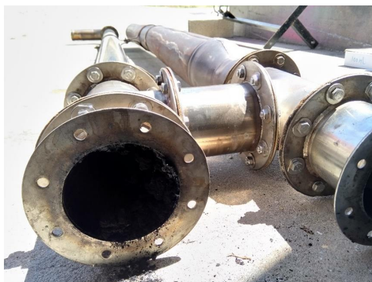
Figura 5.35- Acumulação de material condensável na conduta do queimador após experiência de gasificação.
