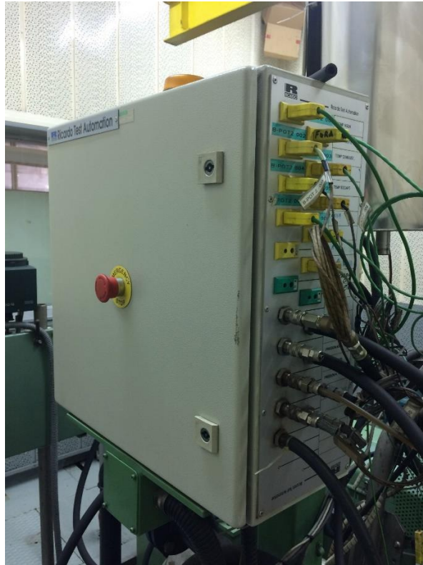
Figura 70 - Caixa de transdutores (temperatura e pressão)
