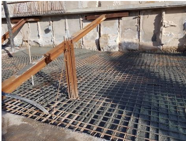
Figura 7 - Juntas de construção visíveis nas Paredes Moldadas
