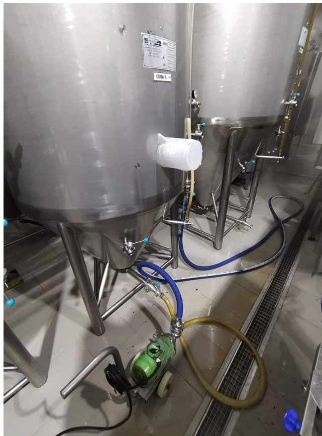
Figura 13 - Sistema de carbonatação na empresa.
