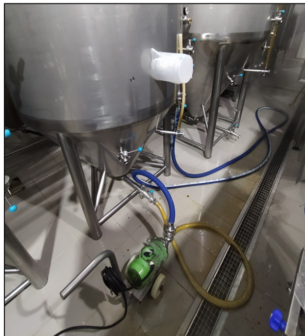
Figura 18 - Sistema de recirculação dos produtos de limpeza e desinfecção na cuba.
