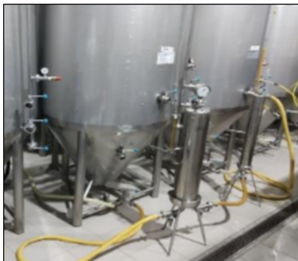
Figura 15 - Sistema de filtração por cartuchos utilizado na empresa.
