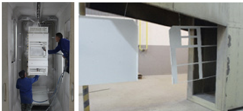
Figura 78 - Elementos na linha de pintura.
