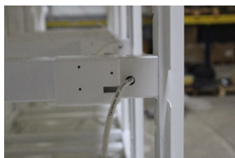
Figura 82 - Terminais dos cabos para ligação dos trincos.
