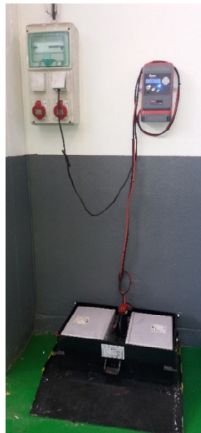
Figura 32: Bateria a carregar.
