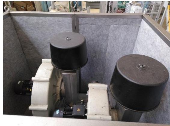
Figura 18 – Estrutura aberta de ventiladores
