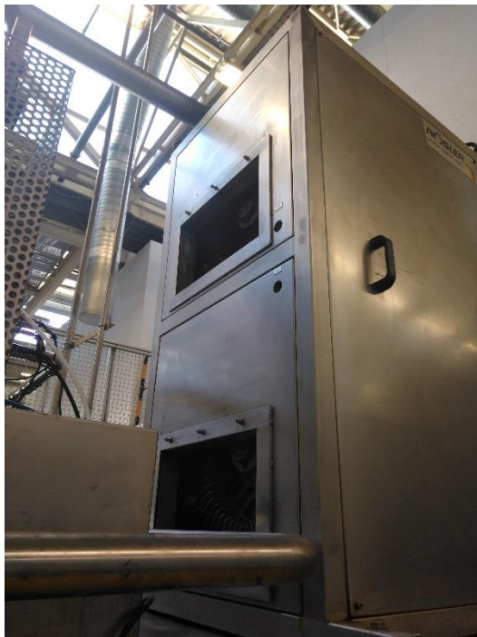
Figura 17 – Habitáculo com turbinas de secagem e sistema de extração do ar da MdL
