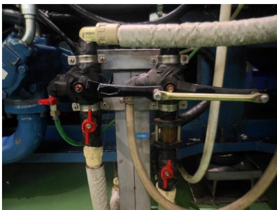
Figura 49: Torneira sem identificação
