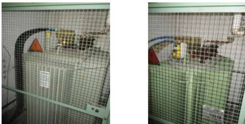
Figura 15 - Fotografias dos transformadores da instalação no PT da empresa
