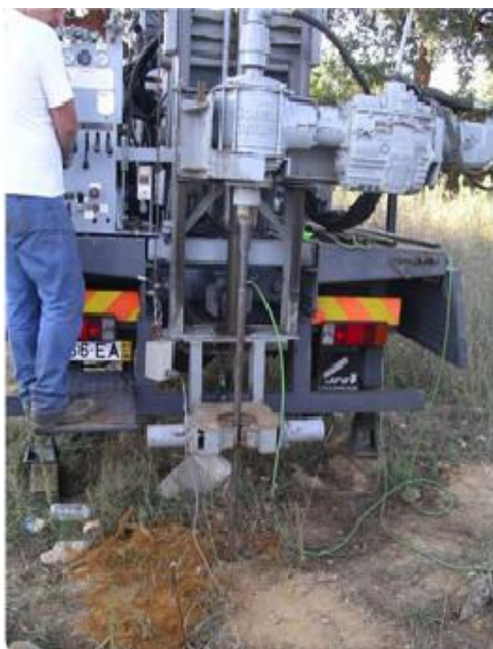
Figura 55 - Camião com equipamento de penetração na traseira
