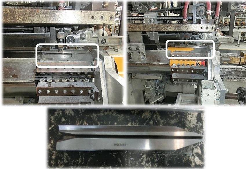
Figura 30: Nova régua de soldadura
