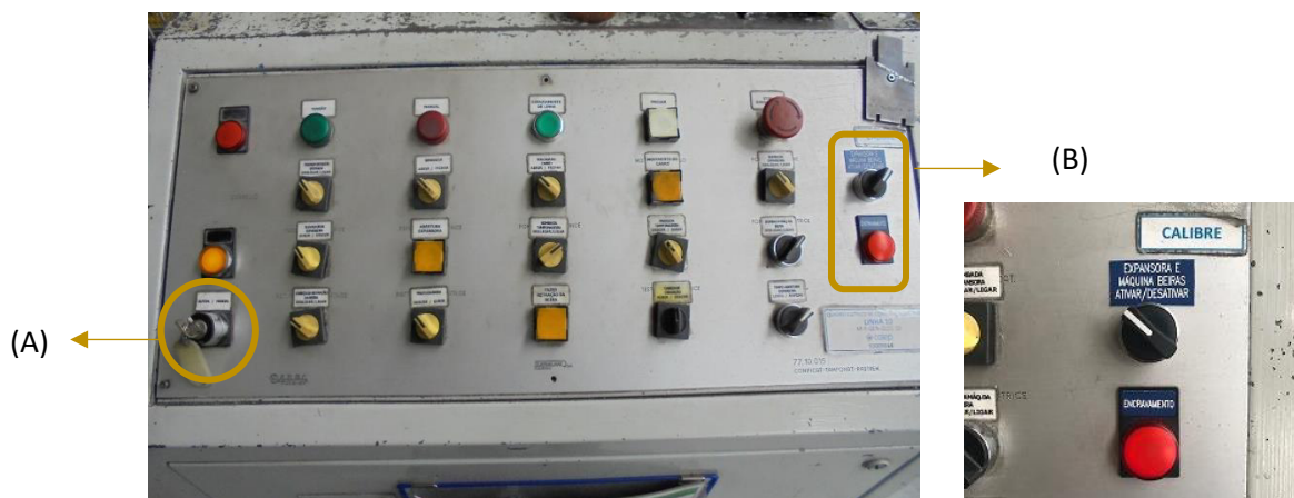
Figura 41: Mecanismos necessários para desativação da expansora e máquina de fazer beira
