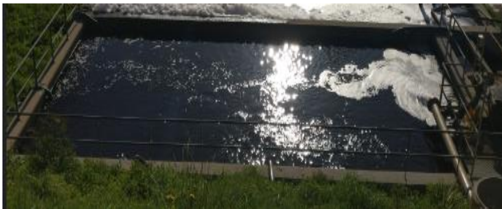
Figura 15. Tanque de homogeneização da ETAL da Recivalongo.
