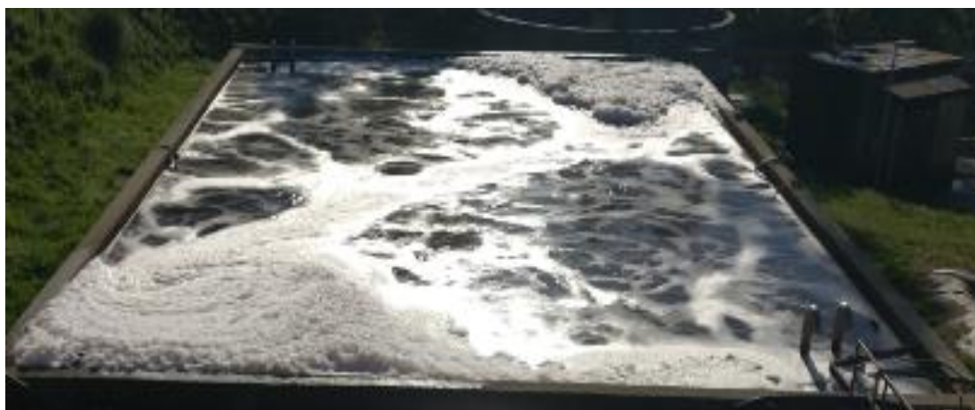
Figura 16. Tanque de arejamento da ETAL da Recivalongo.
