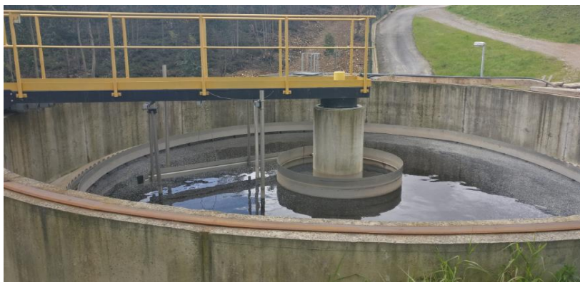
Figura 17. Decantador secundário da ETAL da Recivalongo.
