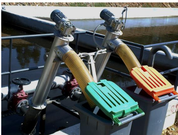
Figura 14. Tamisadores da ETAL da Recivalongo.
