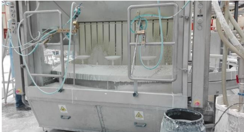
Figura 2 Cabine de aplicação de vidrados por aerógrafo automático
