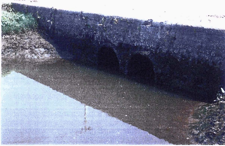
Início do Esteiro, junto à linha do caminho de ferro, com as condutas de entrada da água doce.
