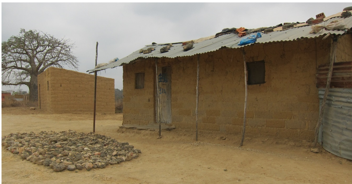
Figura 89 - Precariedade das habitações e das ruas
