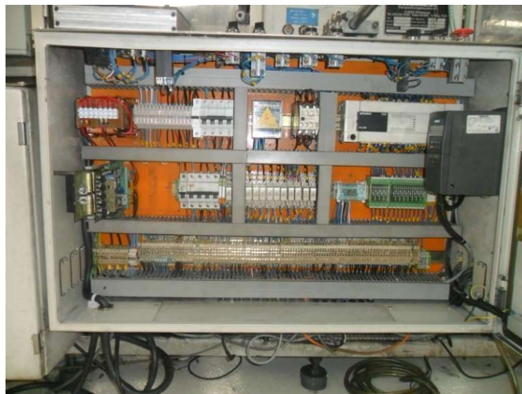
Figura 55: Quadro elétrico da máquina de filme (depois)
