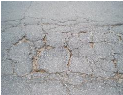
Figura 9 - Pele de crocodilo, fonte: (slides da UC Conservação e Reabilitação de Pavimentos Rodoviários da Universidade de Aveiro).
