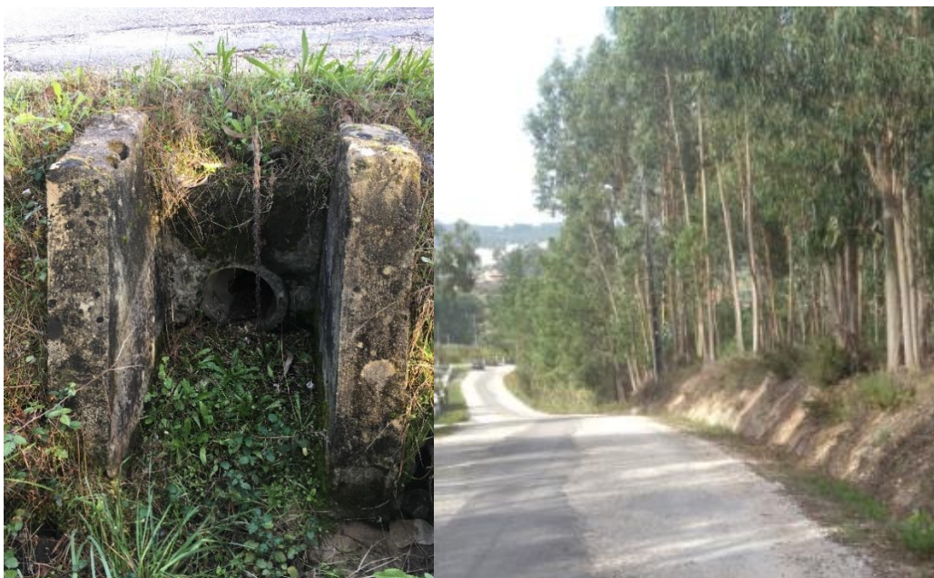
Figura 30 - Condições existentes nos elementos de drenagem e pavimento antes da intervenção.
