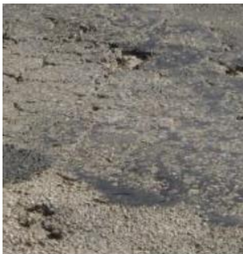
Figura 13 - Ninhos ou covas, fonte: (slides da UC Conservação e Reabilitação de Pavimentos Rodoviários da Universidade de Aveiro).
