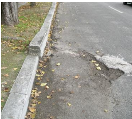
Figura 3 - Deformações localizadas originadas por raízes, (Flórido, 2010).
