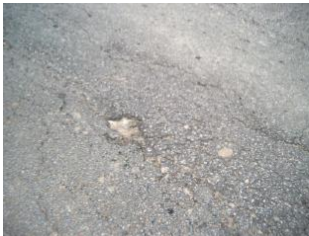
Figura 12 - Pelada, fonte: (slides da UC Conservação e Reabilitação de Pavimentos Rodoviários da Universidade de Aveiro).
