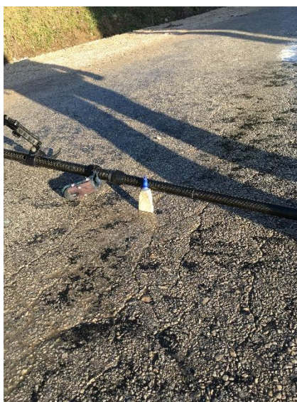
Figura 4 - Abatimentos Longitudinais identificados na obra em estudo.
