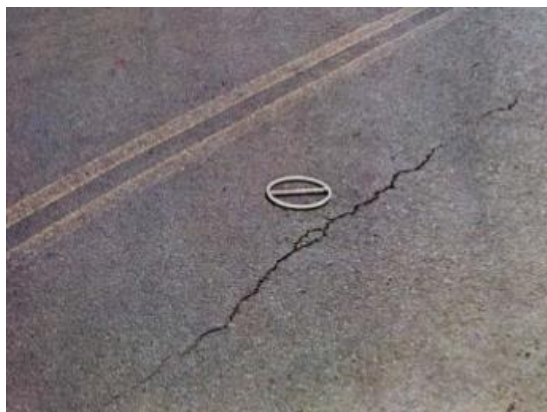
Figura 6 - Fendas Longitudinais, (DNIT, 2003).
