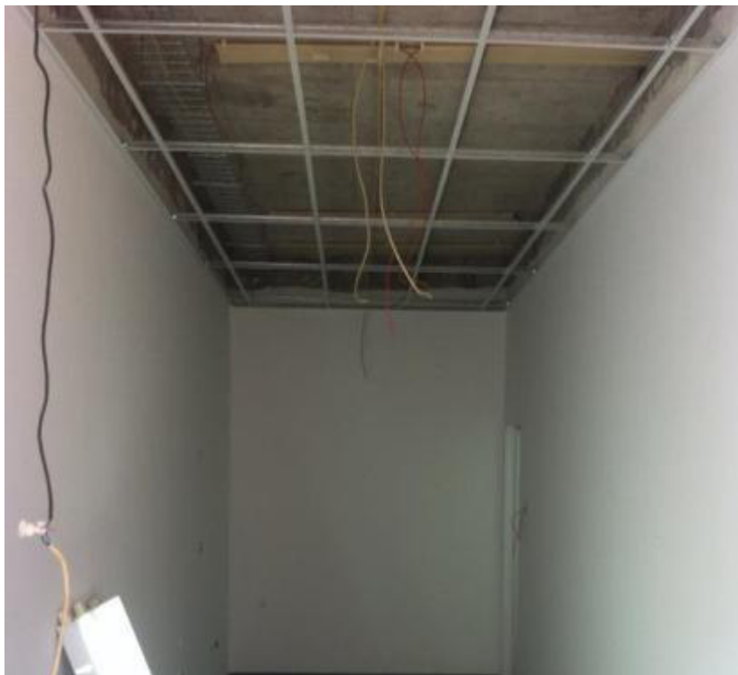
Figura 34 - Estrutura de Tecto falso modular
