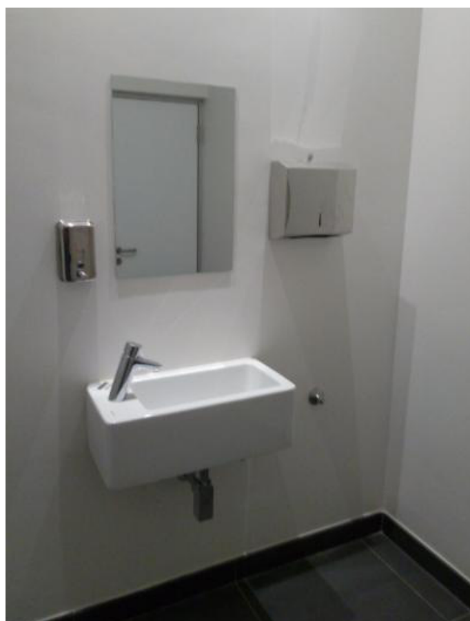
Figura 33 - Lavatório, zona comum
