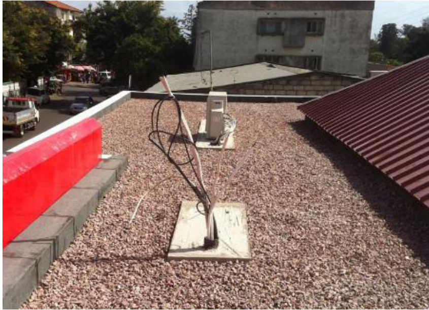
Figura 31 - Pré instalação para unidade exterior de climatização e unidade exterior já instalada
