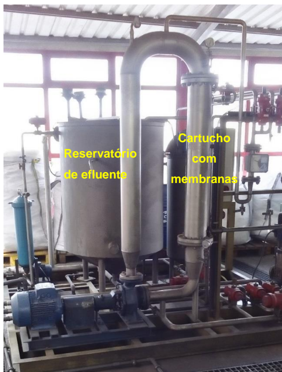
Figura 18 – Unidade de ultrafiltração atualmente existente na SLM (TAMI Industries).
