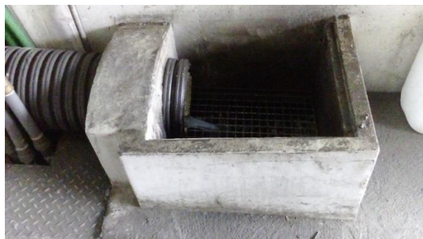
Figura 23 – Canal por onde segue o efluente da Nave 2 (Galeria Técnica 2).
