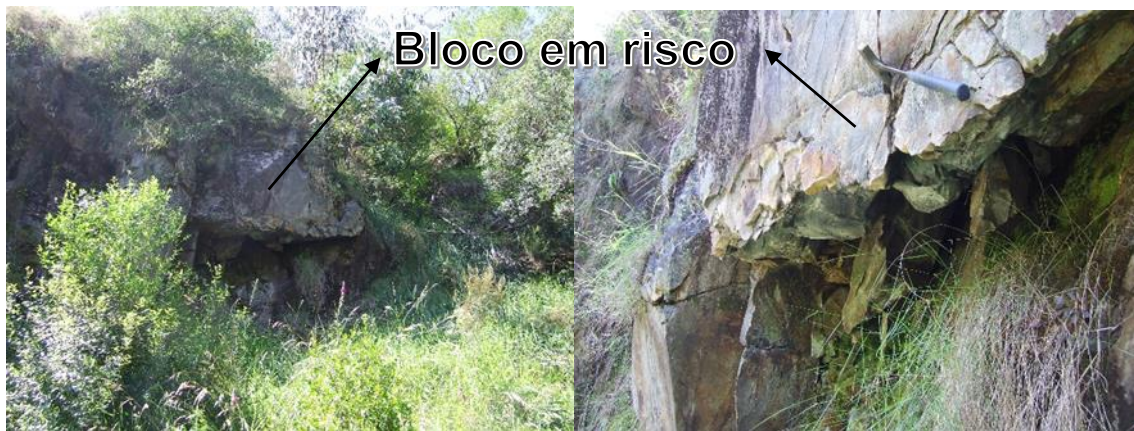
Figura IV-10 Bloco que se apresenta em possível risco antes da secção A
