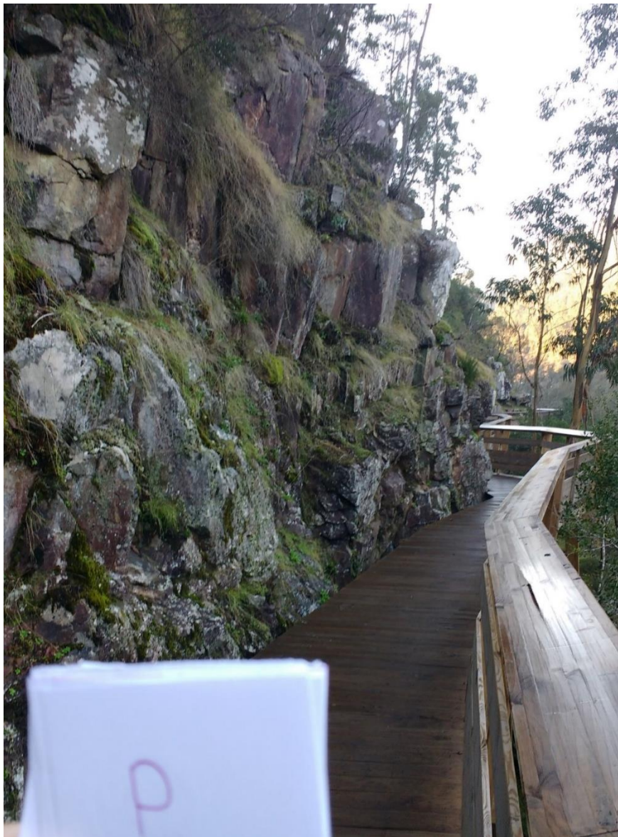
Figura IV-55 Aspeto geral do talude referido como secção P
