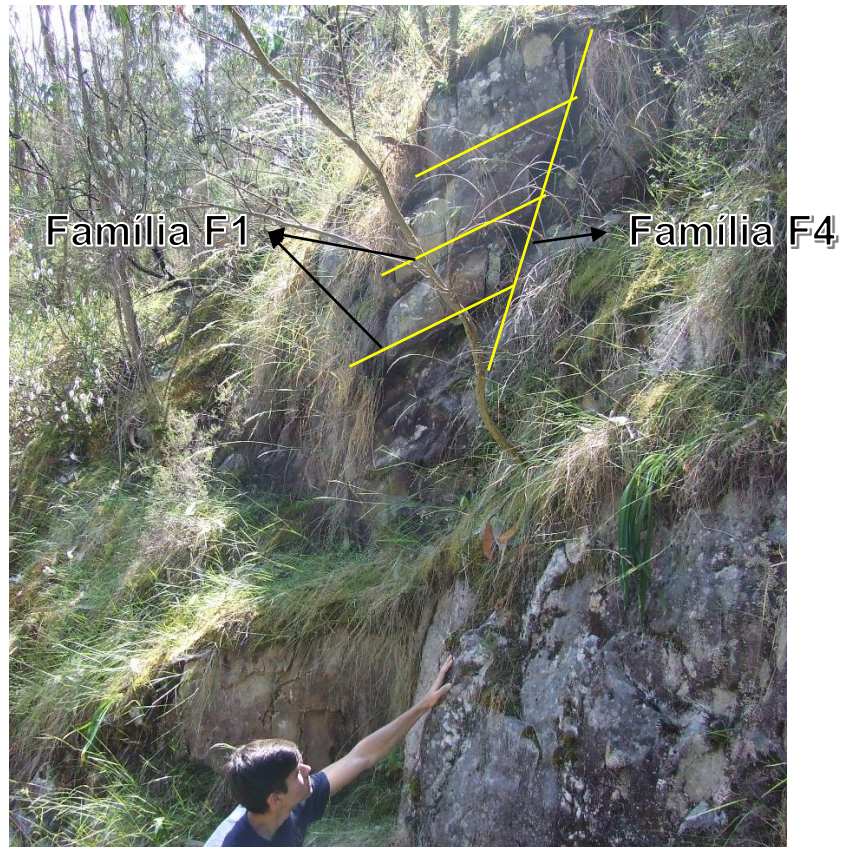
Figura IV-24 Planos que comprometem a estabilidade do talude da secção E
