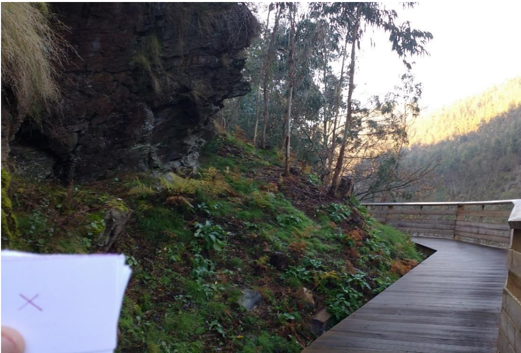
Figura IV-76 Aspeto geral do talude referido como secção X
