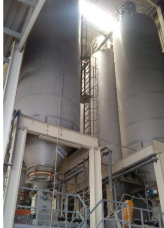
Figura 1 – Vista dos silos de armazenamento da pasta atomizada na unidade de Vagos.
