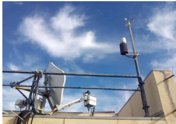
Figura 3.14 – Sistema de receção do sistema Ka-Sat
