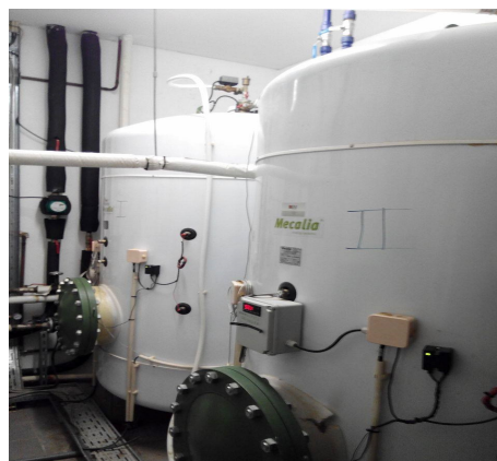
Figura 4.26: Estação de aquecimento de águas sanitárias.
