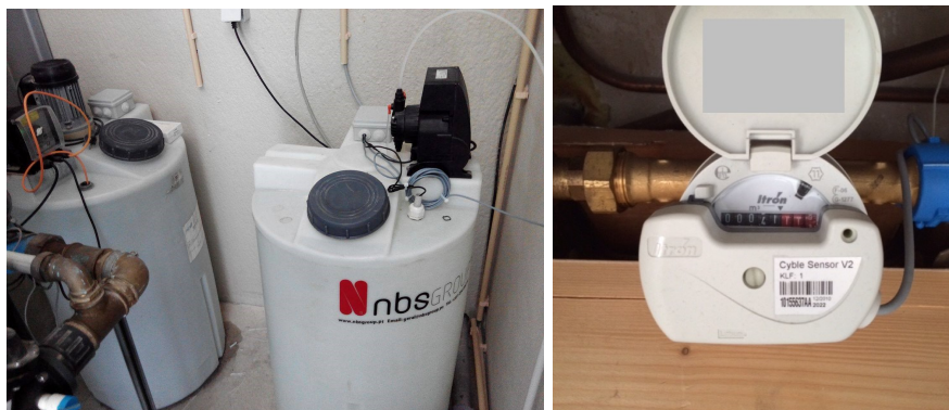
(a) Reservatórios anti incrustante e hipoclorito de sódio. (b) Contador de água com sensor para leitura de consumo de água.
