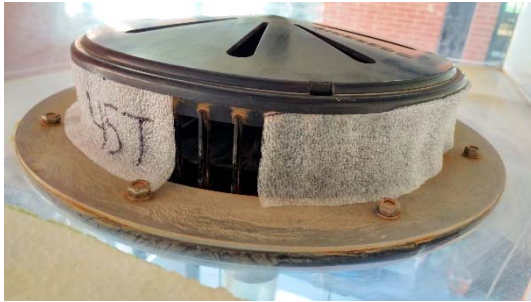
a) Ralo sífónico colmatado lateralmente
