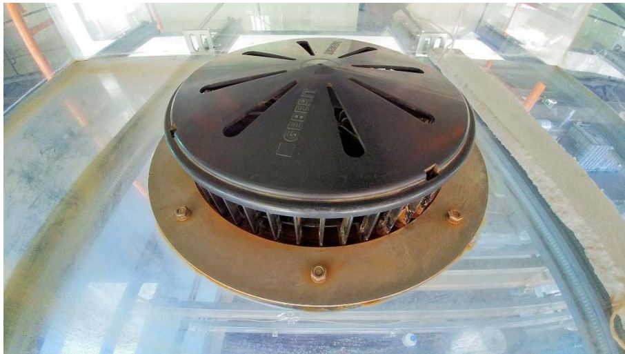
Figura 3.10: Ralo sifônico instalado na cobertura.
