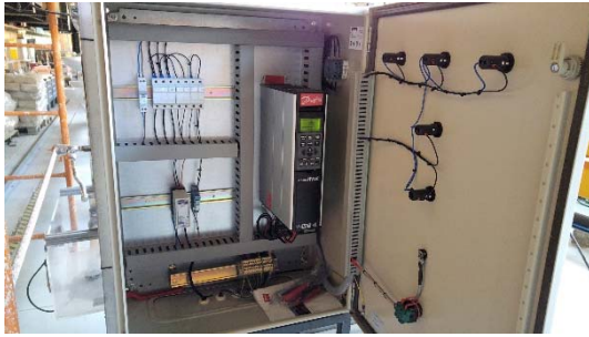
a) Quadro elétrico
