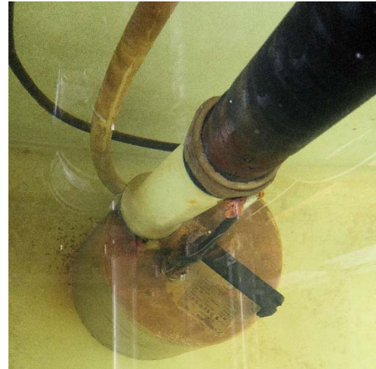
b) Bomba de água instalada
