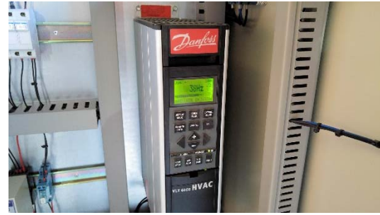
b) Controlador Danfoss VLT® 6000
