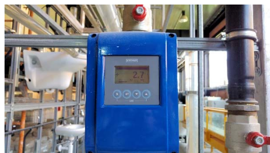
b) Conversor de sinal
