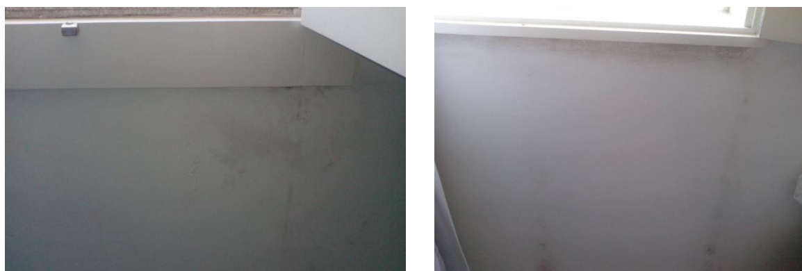
Figura 32 – Mancha de humidade e escorrências na parede sob o vão envidraçado
